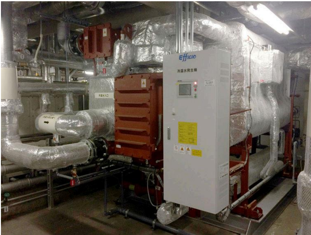
冷温水発生機
